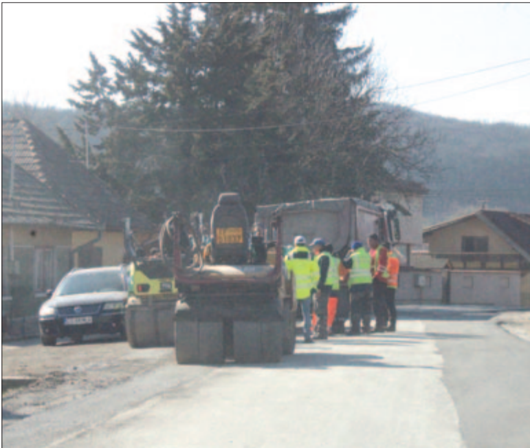
A téli fagyok nyomán alaposan megrongálódott a községben az aszfaltburkolat is, ezért megkezdték a kijavítását
