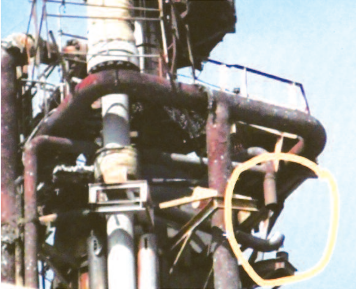
Az illusztráción bekarikázva a meghibásodott vezetékrész látható
